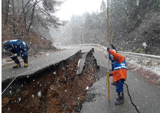
降雪の中、道路の被災状況を調査する東北地整TEC-FORCE (R6.1.15 石川県穴水町)
