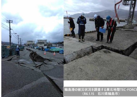
輪島港の被災状況を調査する東北地整TEC-FORCE (R6.1.15 石川県輪島市)
