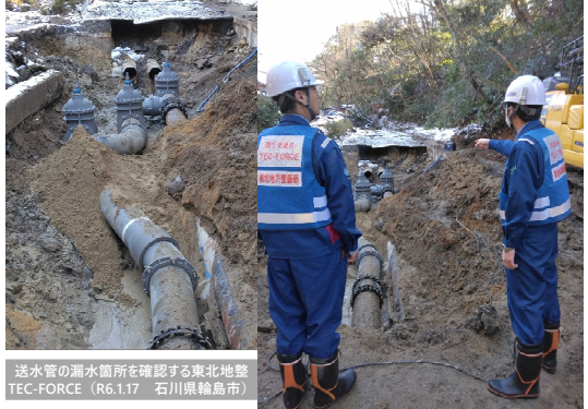
送水管の漏水箇所を確認する東北地整TEC-FORCE (R6.1.17 石川県輪島市)
